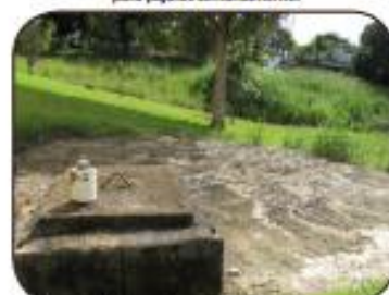
Mantenga el pozo séptico sellado.
