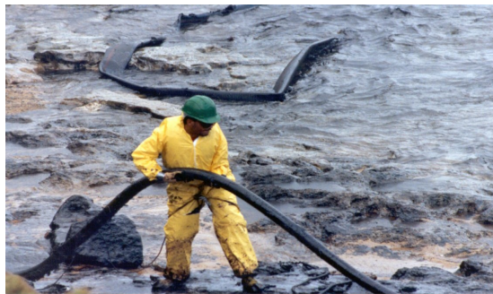
Limpieza derrame de petróleo barcaza Morris J. Berman
